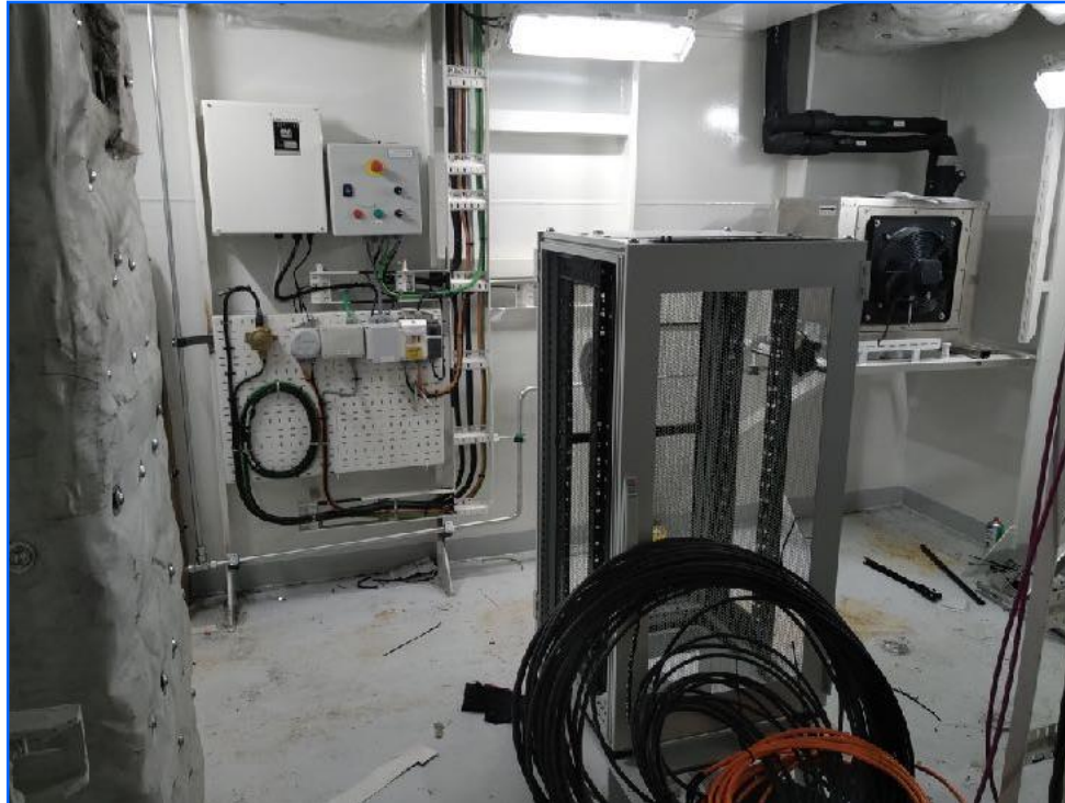
Sonar Room : Rack Science en place , cables non raccordés
